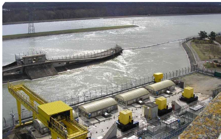
Figure 6.3.1.2.a Vues aériennes de l'ouvrage de prise d'eau et de la station de pompage
