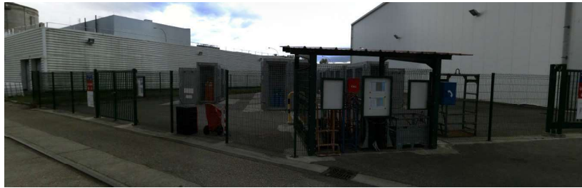
Figure 6.2.9.2.a Parc à gaz GNU
