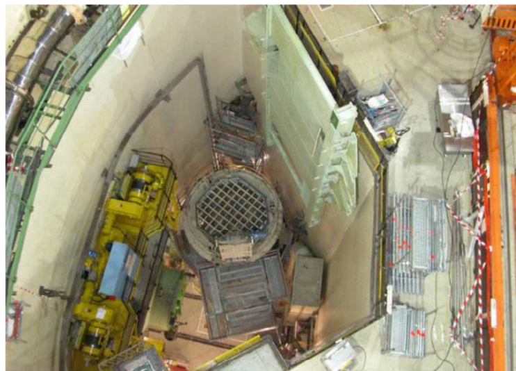
Figure 6.2.1.4.a Trémie de manutention
